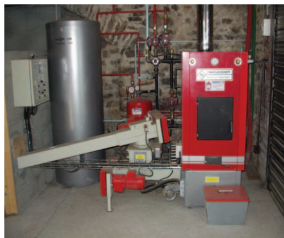
Chaudière automatique à bois déchipeté
